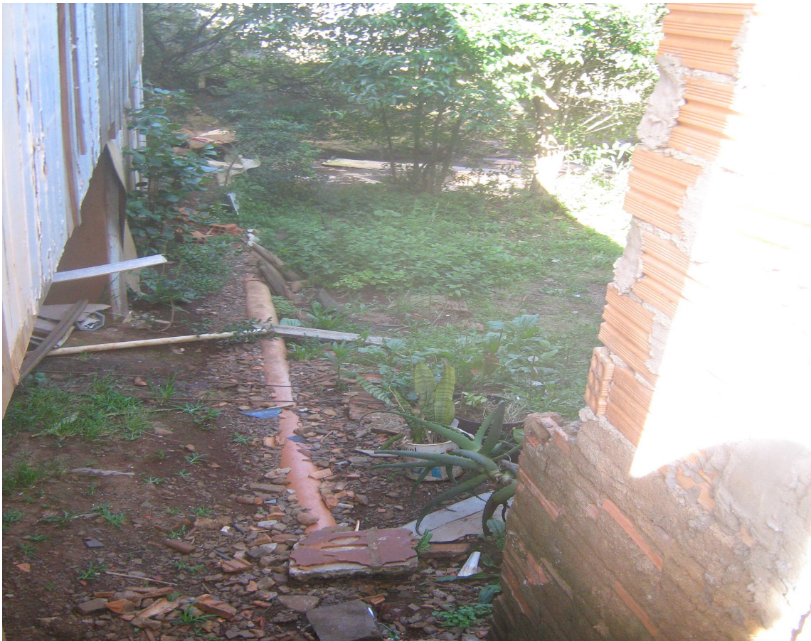
Foto tirada da tubulação de esgoto escoando direto no córrego
